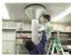
RI施設設備点検(風量測定)
